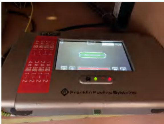
图 7 泄漏监测监控系统
