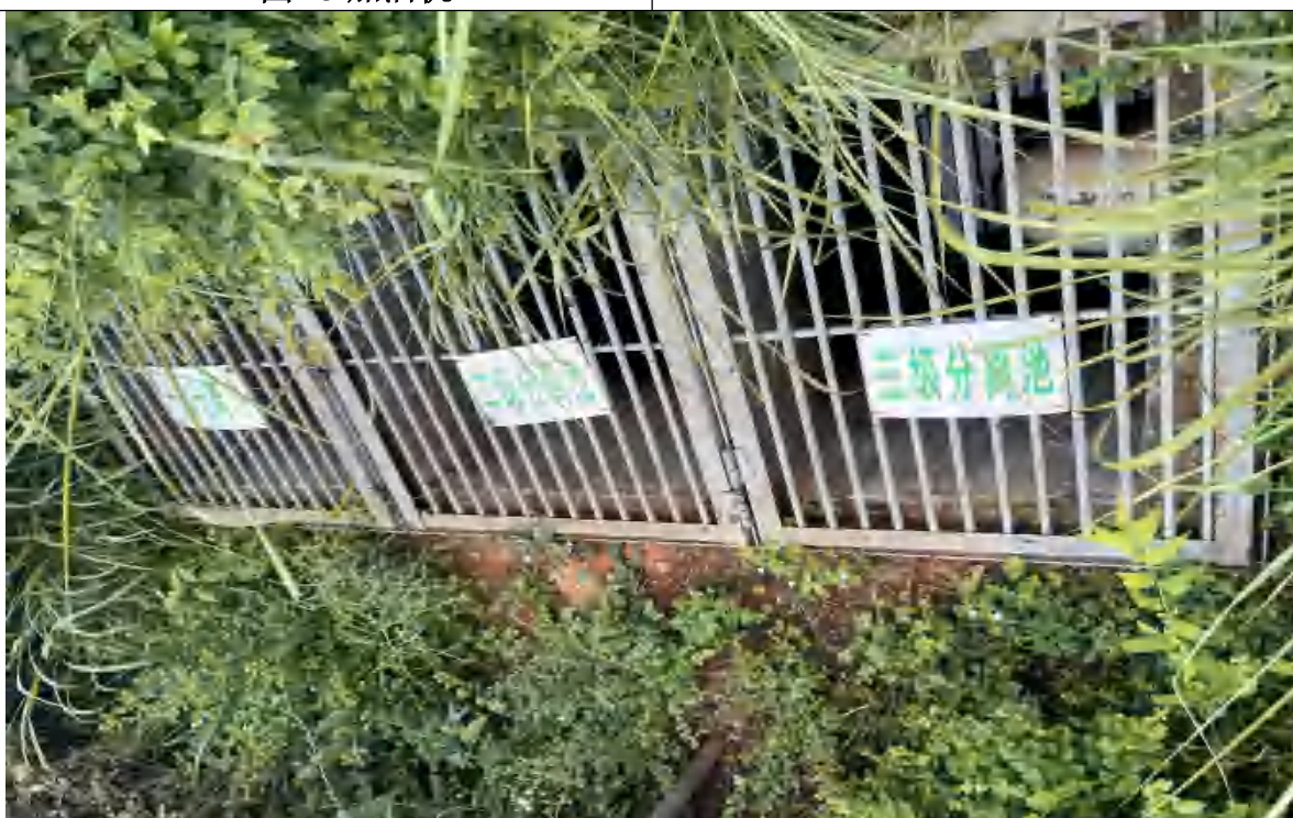
图 15 站房西面绿化地内的隔油池
